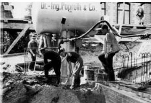
Druckluftbehälter und Schleuse
